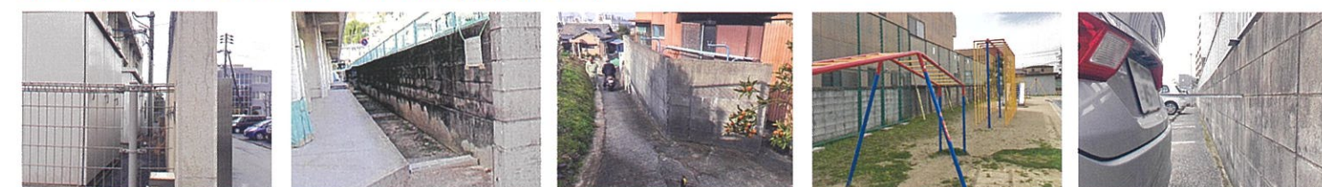
建物と近接している現場の塀 狭あい箇所での現場 動線が狭く搬入が難しい現場 塀の改修に伴い遊具移設が発生 車止めを移設できない駐車場
